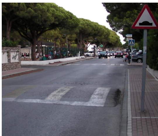
Paso de cebra elevado deteriorado por paso de transporte público en Roche
