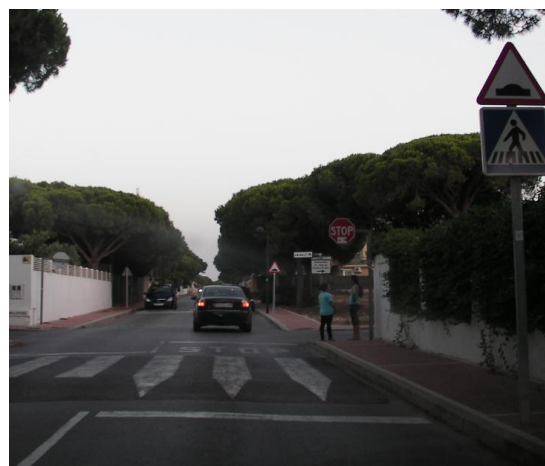
Deficiencias de geometría y drenaje en pasos de cebra elevado en Roche
